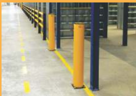
Postes usados para proteção de colunas de entrada em instalações de armazenamento.
