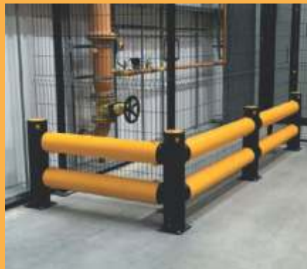
iFlex Barreira de Tráfego Dupla protegendo sistema de aspersão em uma fábrica de processamento de alimentos.
