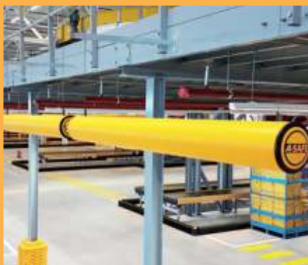
Múltiplas Barras de Alarme instaladas para proteção de estrutura suspensa
