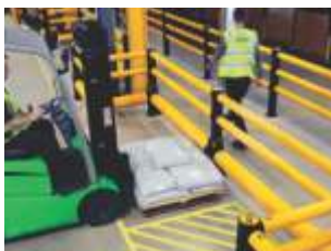
14 Barreira de tráfego PLUS
