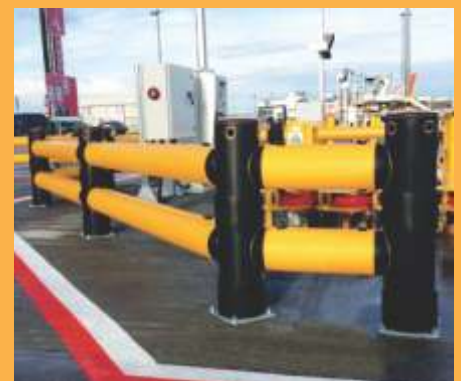
Atlas Barreira de Tráfego Dupla protegendo um poste da iluminação em pista de decolagem de um aeroporto.
