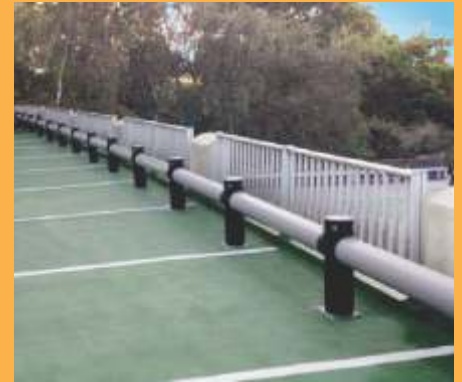
iFlex Barreira de Tráfego Simples em Nível Alto protegendo o perímetro de um estacionamento de dois andares.
