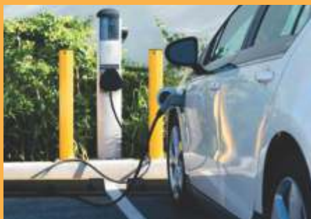
Postes protegendo o ponto de carregamento do carro elétrico.
